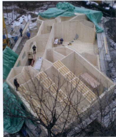
Vormvaste prefab panelen worden op de bouwplaats in korte tijd in elkaar gezet
